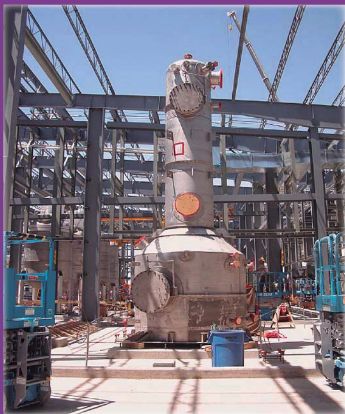
Planta de lavado de Gases (Scrubber)
